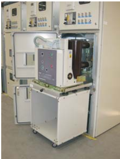
Рисунок 39. Сервисная тележка вошла в зацепление с ячейкой распределительного устройства.
